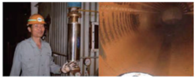
安装 结垢未变硬, 沾手套 (下部滚筒内部)
