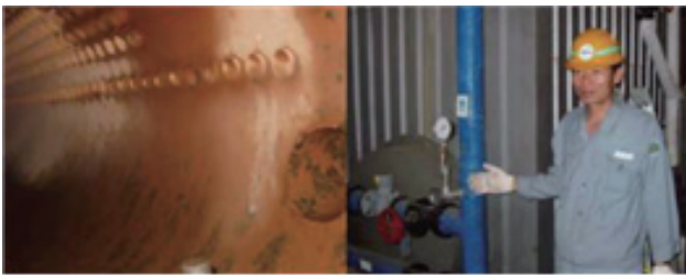
未安装 结垢变硬, 不沾手套 (下部滚筒内部)
