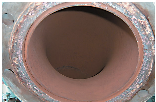
使用IOREX后的管道 管道内异物黏着程度减少
